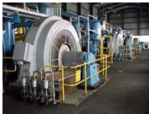
Obr.4.1. Kompresory na stlačení syntézního plynu
