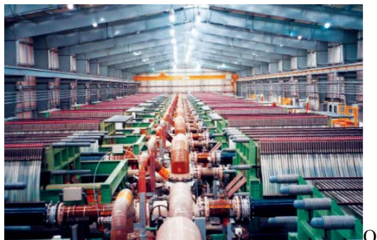
Obr. 7.3. Hala s membránovými elektrolýzery (Bayer)
