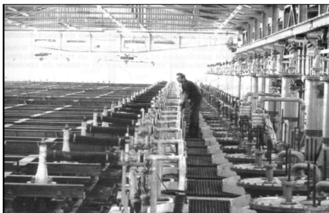
Obr. 7.5. Hala s amalgámovými elektrolyzéry. Protože elektroda je tvořena hladinou rtuť, zabírají elektrolyzéry velkou podlahovou plochu.
