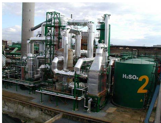
Obr.5.1. Pro výrobu \text{H}_2\text{SO}_4 jsou charakteristická mohutná izolovaná potrubí pro plané proudy. Mezi nimi je věž pro oxidaci \text{SO}_2 . Obsahuje náplň křemelinových tablet, pokrytých \text{V}_2\text{O}_5 . Další věží je absorpční kolona.
