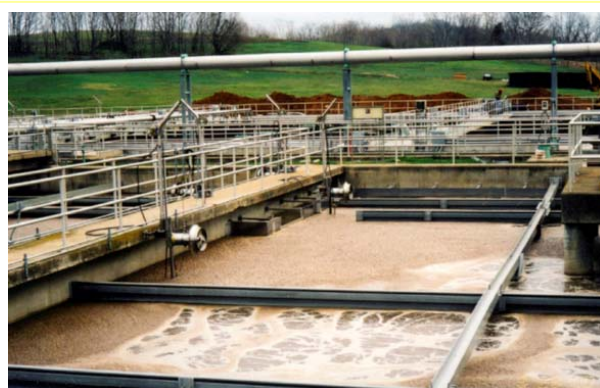
Obr. 9.3. Aktivační nádrž provzdušňovaná tlakovým vzduchem
